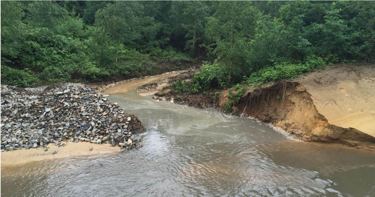
Doorgebroken dam van regenwaterbuffer (foto Jos Hoogveld)
