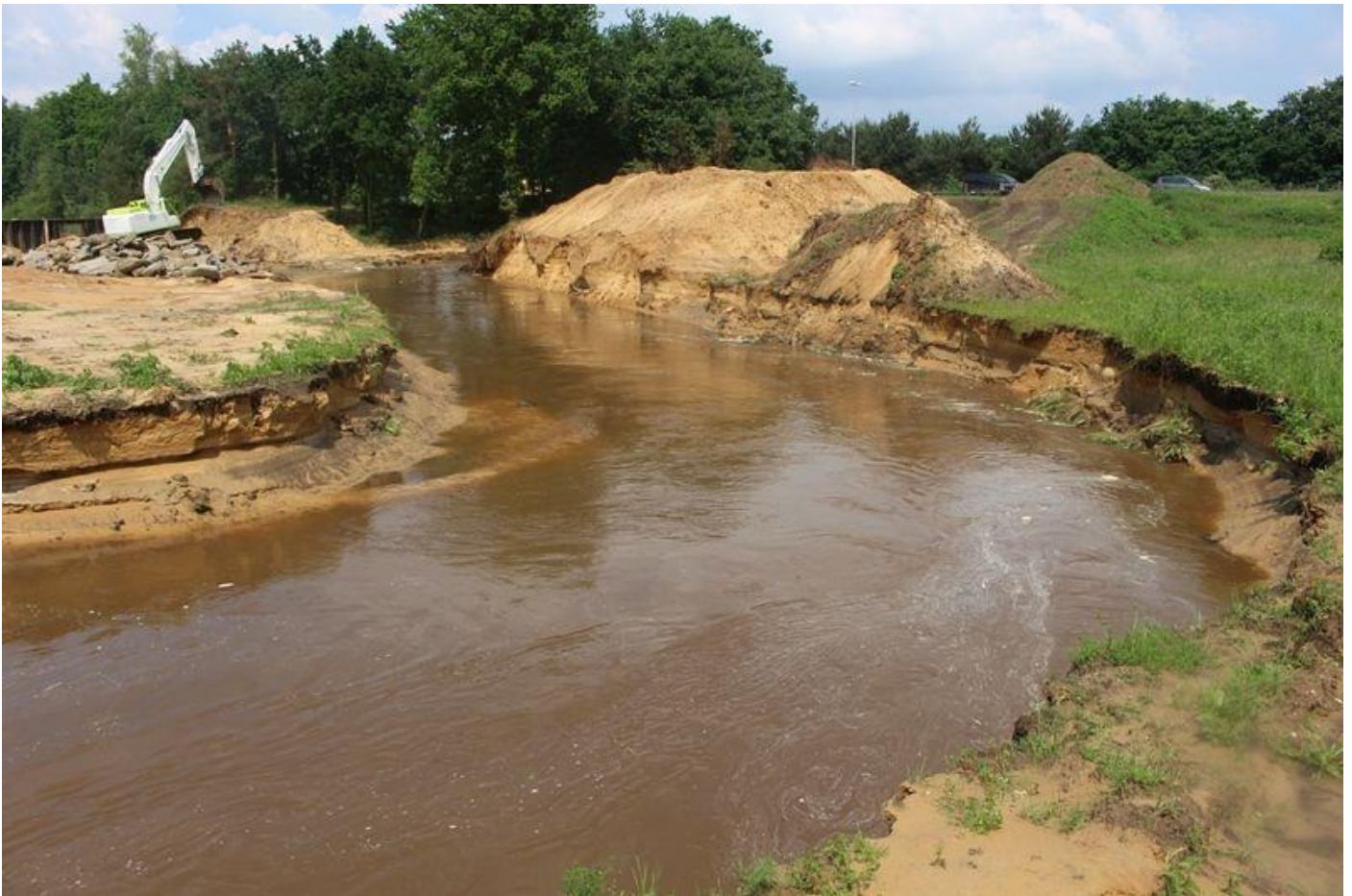
Everlosebeek tijdens hoge afvoer. De buitenbochten zijn sterk afgekalfd, waardoor ruim 50 oeverwaluwnesten zijn verdwenen
